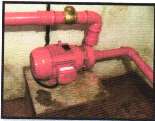
Figura 16 - Bomba de Incêndio
